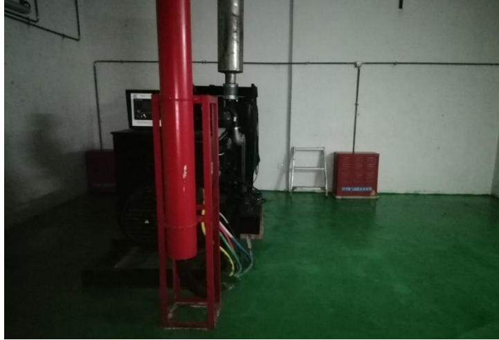
图 4-3 项目地下室柴油发电机
