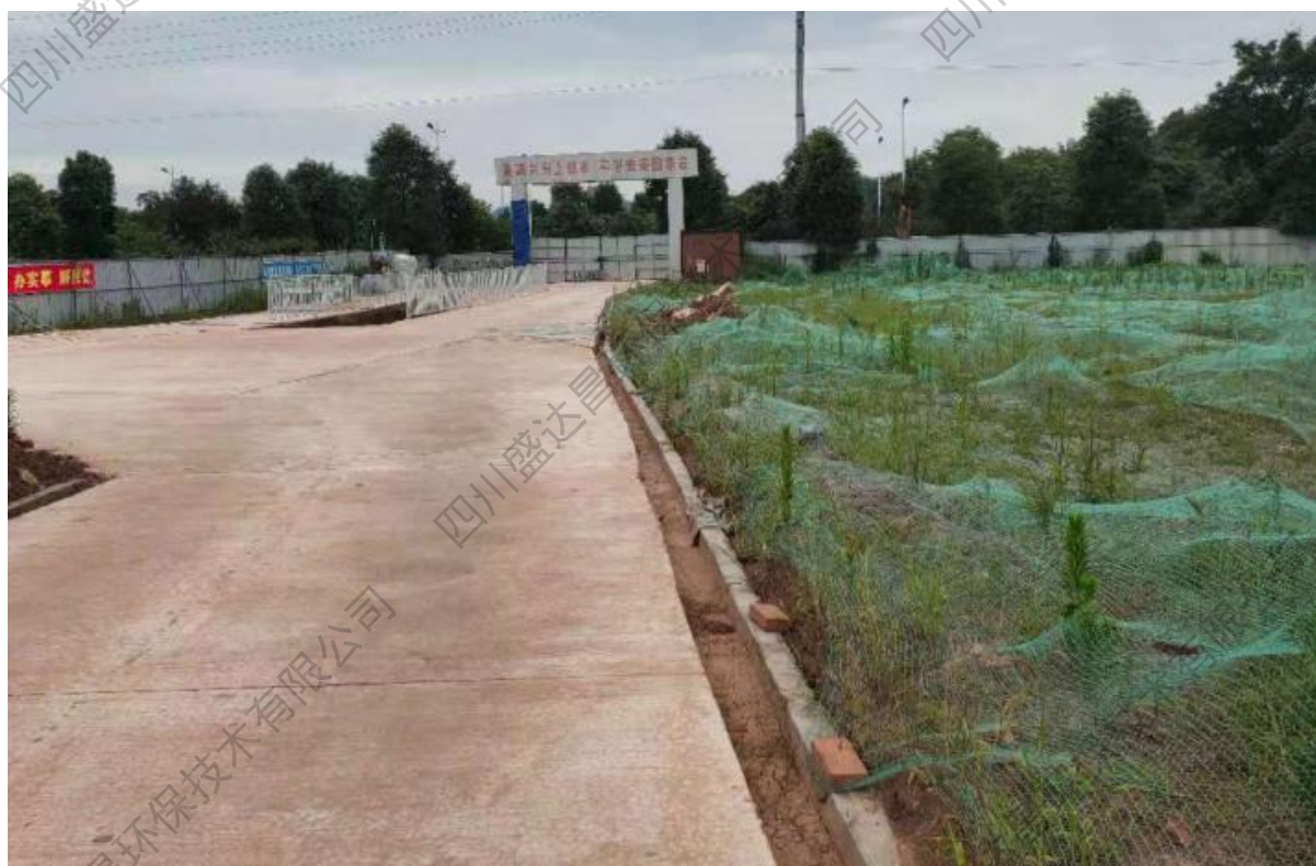
图 1.1-4 临时排水沟及密目网措施现状
