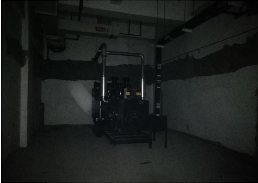
图 4-4 项目地下室柴油发电机
