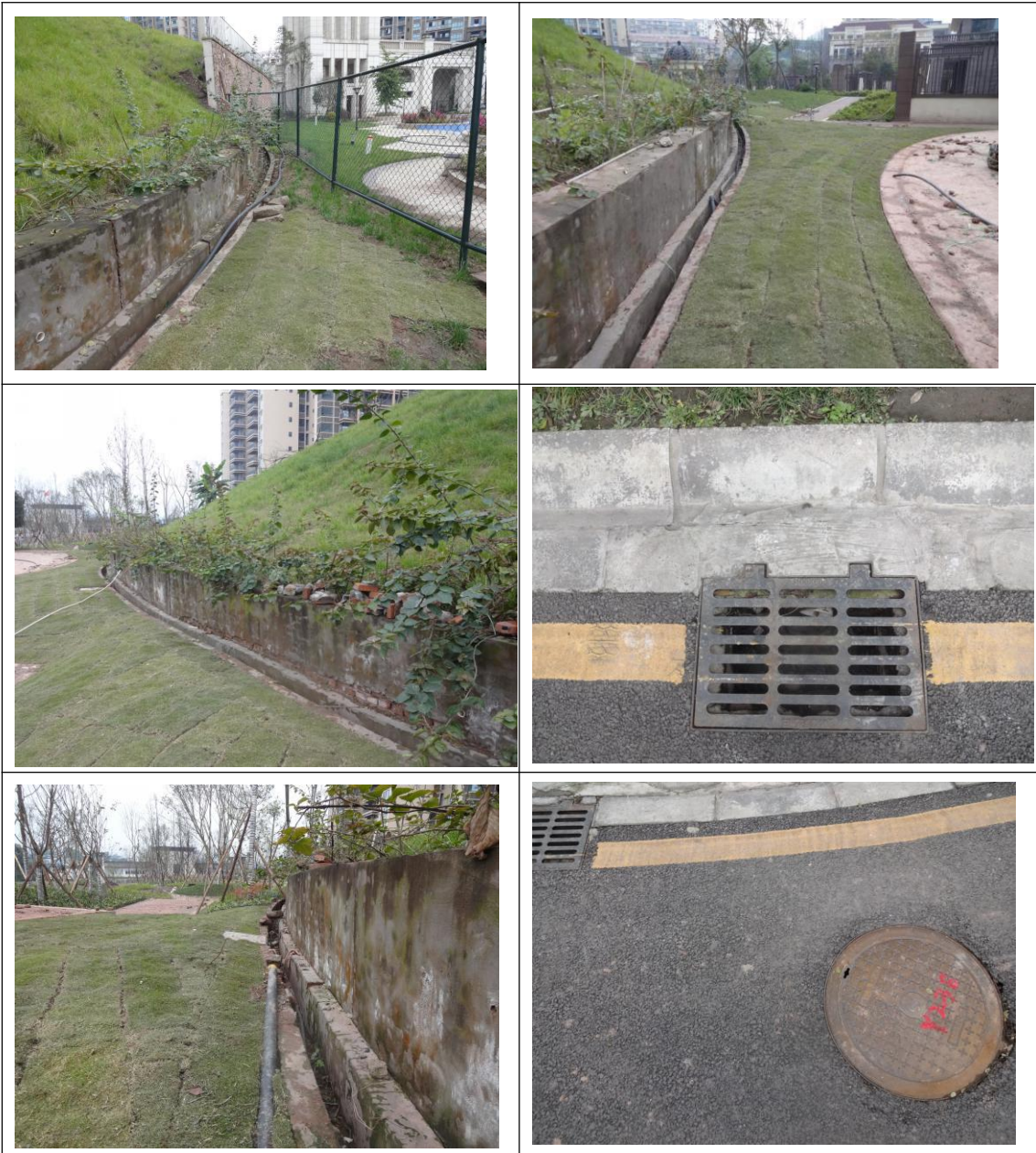
小区排水设施
